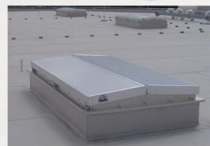
Einzelgeräte auf einem Industriedach
