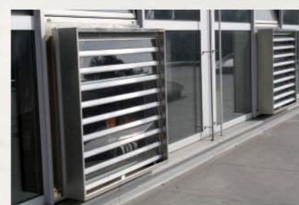
Mit Isolierglas ausgefachte SMOKEJETs
