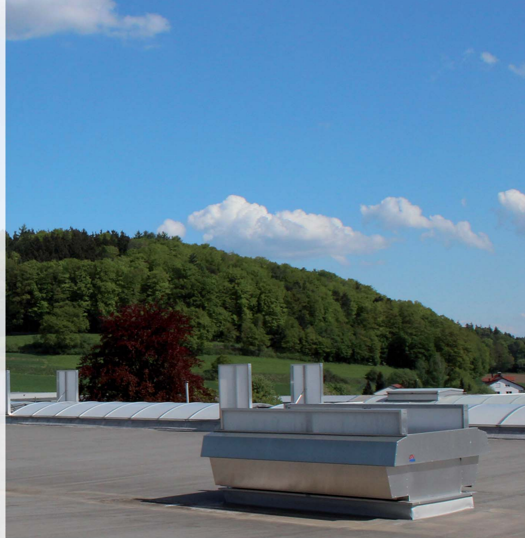
Großes Bild: MEGAPHÖNIX als Einzelgerät auf einem Industriedach
