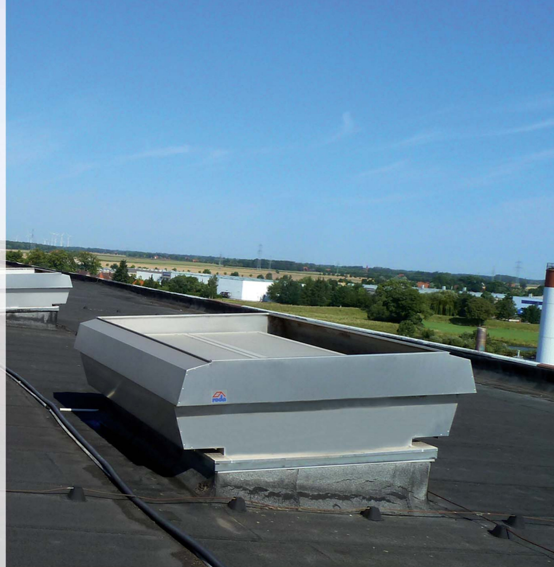
Großes Bild: Mehrzwecklüfter Typ MEGASTAR auf einer Produktionshalle
