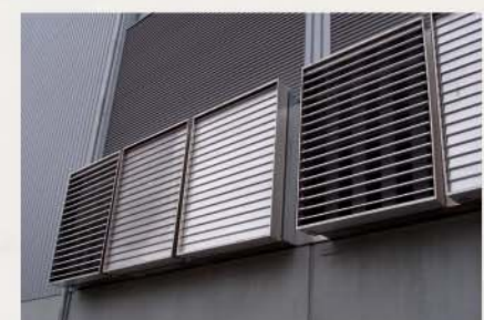
SMOKEJETs als seitliche Zuluftöffnung
