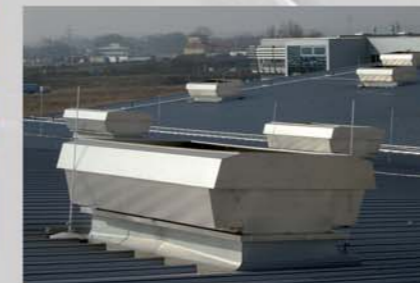
Einzelgeräte auf einer Industriehalle
